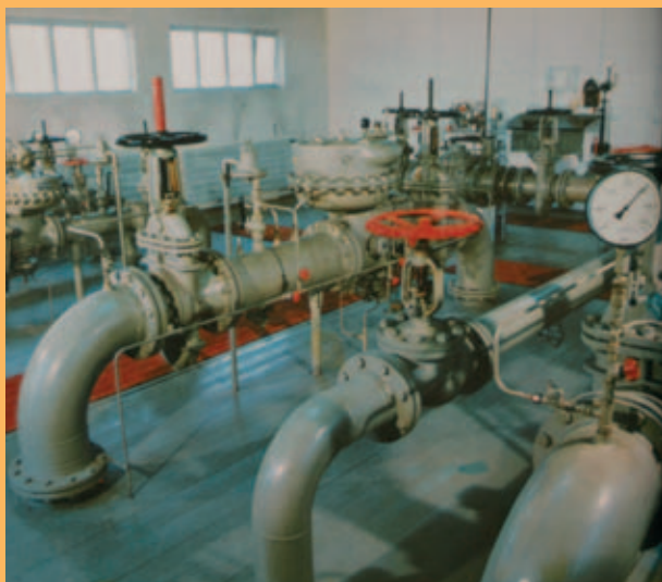
Übernahmestationen führen das Erdgas dem Verteilersystem zu. (Repro: Jahresbericht Stadtwerke Solingen 1981)
